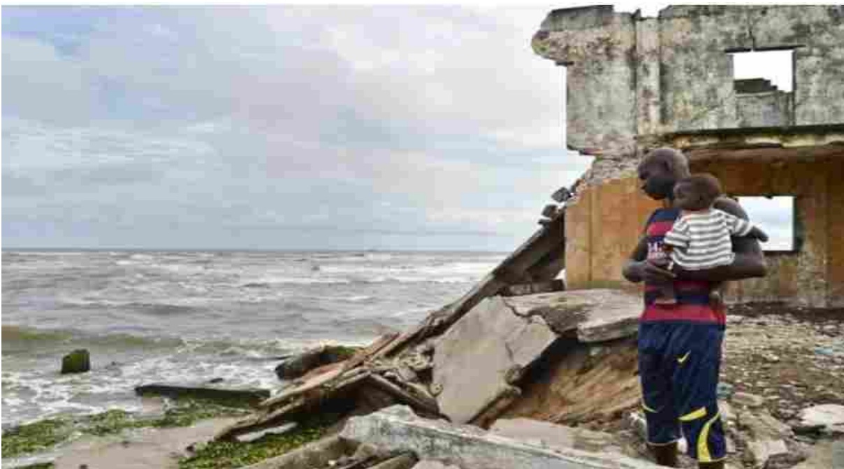
Figure 10 : Érosion côtière à Grand-Lahou (site de la préfecture de Lahou Kpanda).
